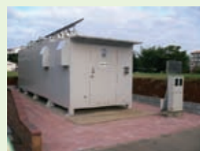
千葉支店グループが構築した環境配慮型 RT-BOX
