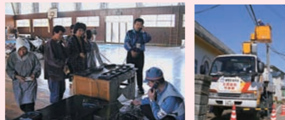
左：避難所での特設公衆電話の設置 右：災害後の通信ケーブルの応急復旧作業
