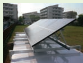
RT-BOX の屋根に設置した太陽電池モジュール
